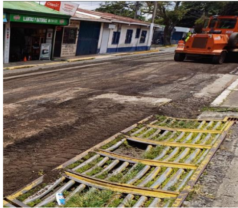
Imagen 13. Cordón y caño con obstáculos que impiden la correcta evacuación de las aguas
